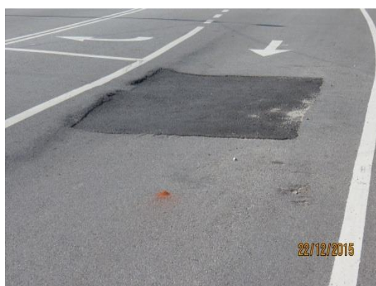
Gambar 1.14 Tampalan Jalan Yang Dikorek Tidak Rata
