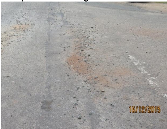
Gambar 1.12 Tampalan Jalan Yang Dikorek Tidak Rata
