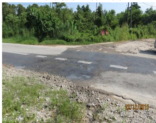
Gambar 1.2 Bahu Jalan Tidak Rata
