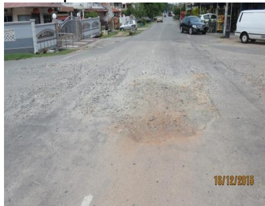
Gambar 1.4 Tampalan Pothole Tidak Kemas
