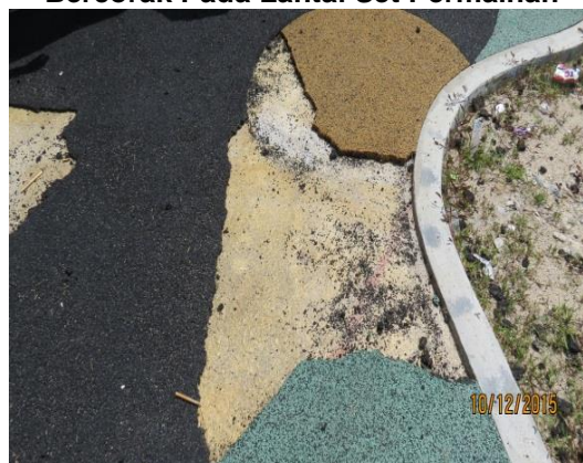
Gambar 3.12 Kerosakan EDPM Seamless Flooring Bercorak Pada Lantai Set Permainan
