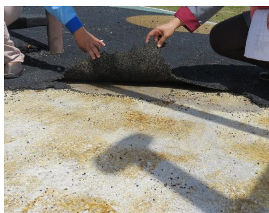
Gambar 3.16 Mudah Terkoyak Dan Tidak Melekat Pada Lantai Konkrit
